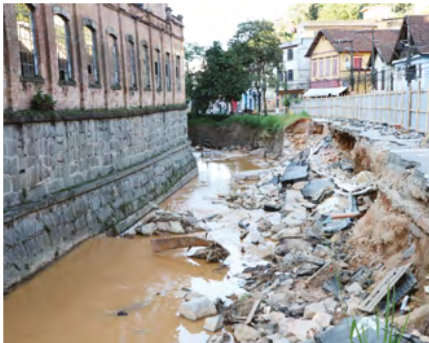
Trecho da rua Washington Luiz, em Petrópolis (RJ), foi completamente destruído por causa da forte chuva que abalou a cidade e deixou centenas de mortos
